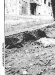
Buracos em calçada representam risco para pedestres
